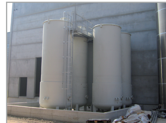
SERBATOI SU GAMBE DA 30 MC RISCALDATO PER OLII PASTIFICANTI 30 M 3 HEATED TANKS ON LEGS FOR PLASTICISER OILS
