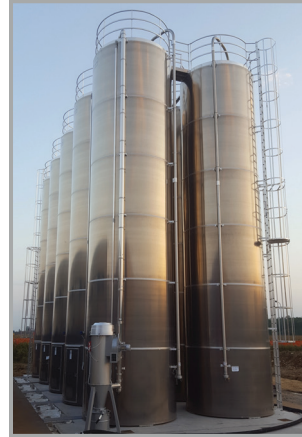
IMPIANTO DI STOCCAGGIO CON ZONA DI CARICO CENTRALIZZATA STORAGE PLANT WITH CENTRALISED LOADING ZONE
