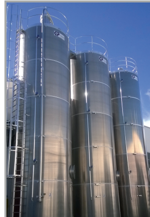
SILOS E STRUTTURA SU CELLE DI CARICO SILOS AND FRAME ON LOAD CELLS
