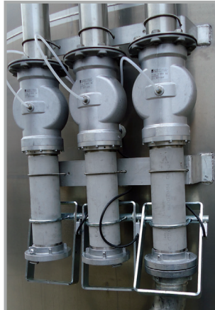
SISTEMA DI SICUREZZA SAFETY SYSTEM
